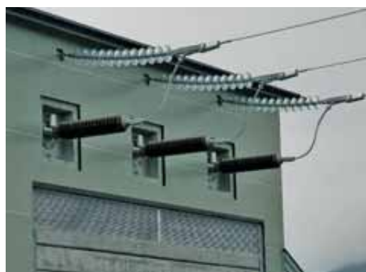
> Transformador pasabarra. Interior-exterior. Subestación de distribución.
