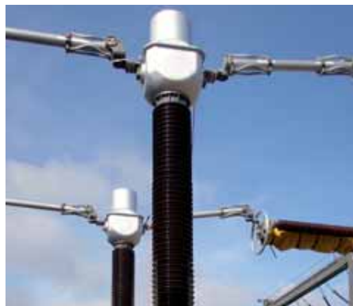
3. Transformadores de intensidad de 420 kV. National Grid (Reino Unido).
