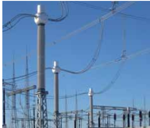
1. Transformador de intensidad de 765 kV. RAO-FSK (Rusia).
