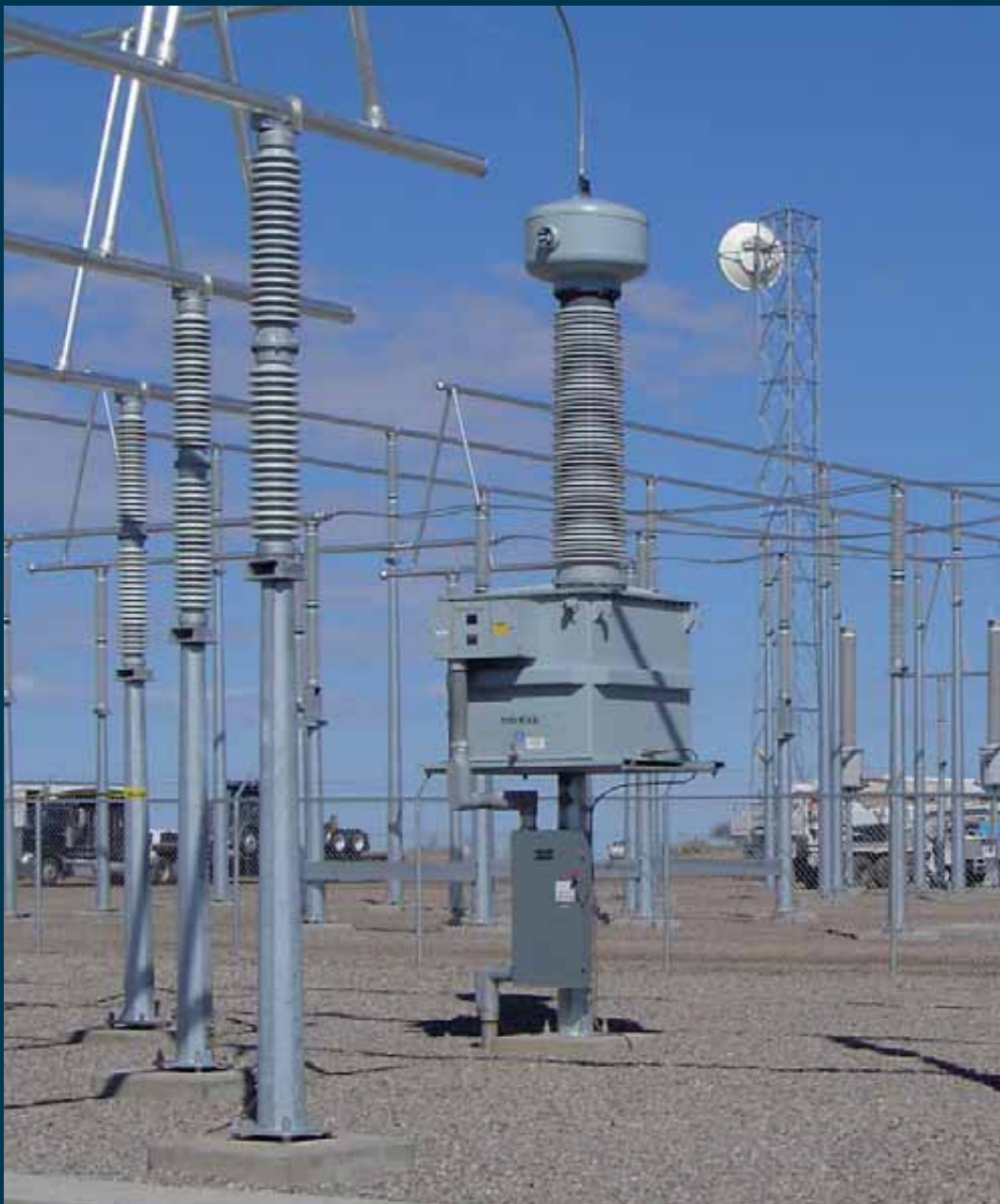
› Transformador para servicios propios de la subestación modelo UTP de 245 kV. Coyote Switch (Estados Unidos).
