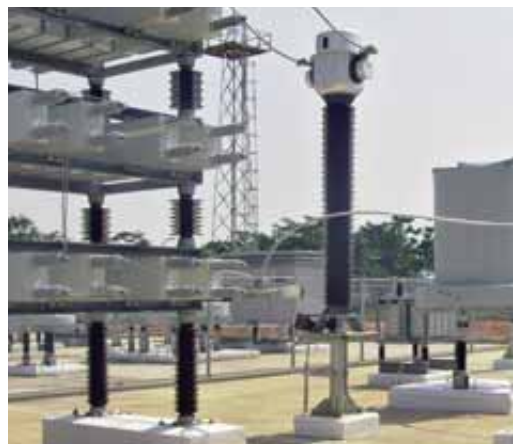
2. Transformador de intensidad de 245 kV protegiendo banco de condensadores (India).
