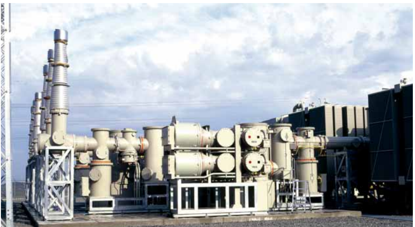
► Transformadores de tensión en una subestación GIS.
